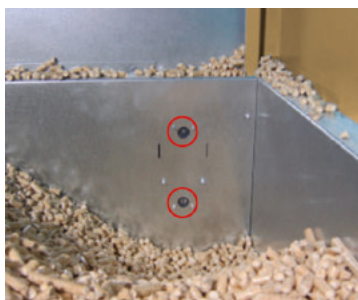
Sensor de nivel de combustible en el depósito.
